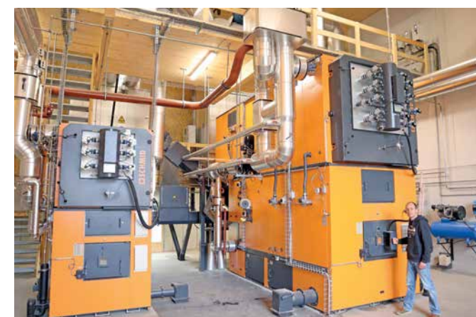
Lukas Frei begutachtet die Anlage – er ist Vorstandsmitglied der Heizgenossenschaft Knonau.
